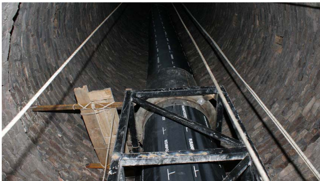
Рис.9 Труба Фуранфлекс в смонтированном положении внутри дымоходной кирпичной трубы. Труба Фуранфлекс представляет собой отдельный ГОС.
