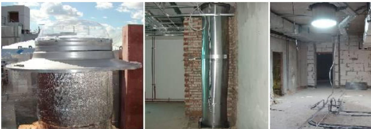
Рис.1. ПТС, установленный в здании ОАО «Банк Москвы» (по окончании монтажных работ) [4]
