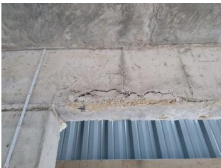
Рис. 3. – Горизонтальные трещины, пустоты в бетоне
