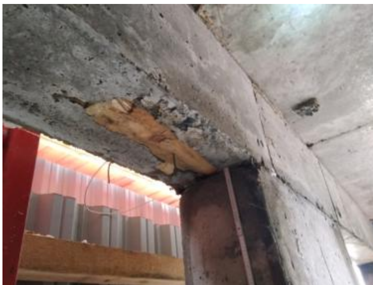
Рис. 1. – Инородный предмет в теле монолитной конструкции
