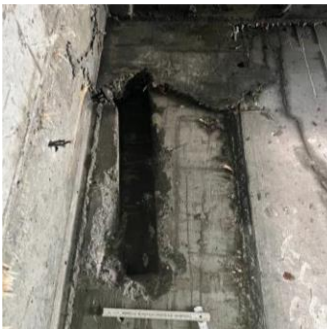
Рис. 10. – Нарушение целостности монолитной конструкции
