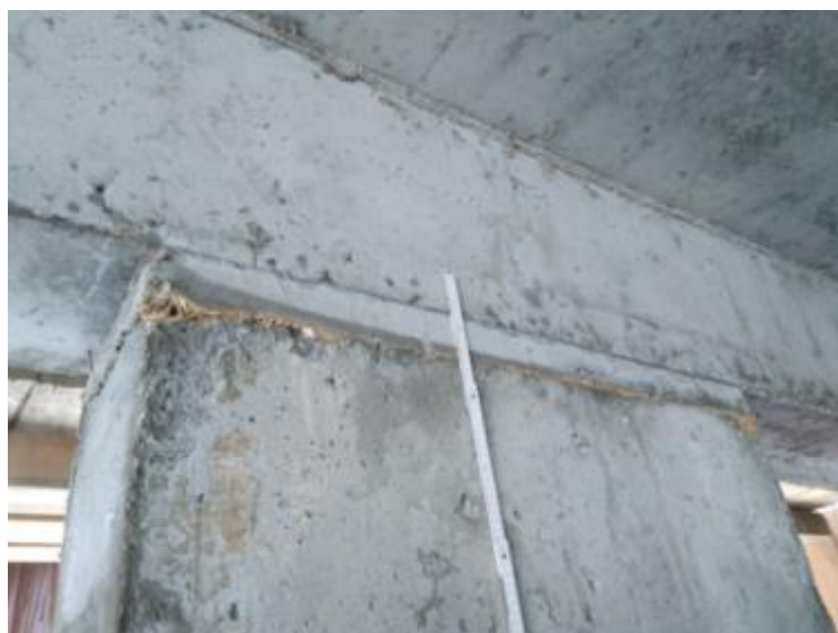
Рис. 7. – Холодный шов бетонирования
