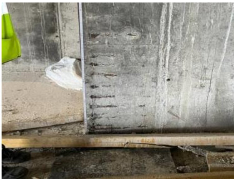
Рис. 2. – Обнажение арматурных стержней
