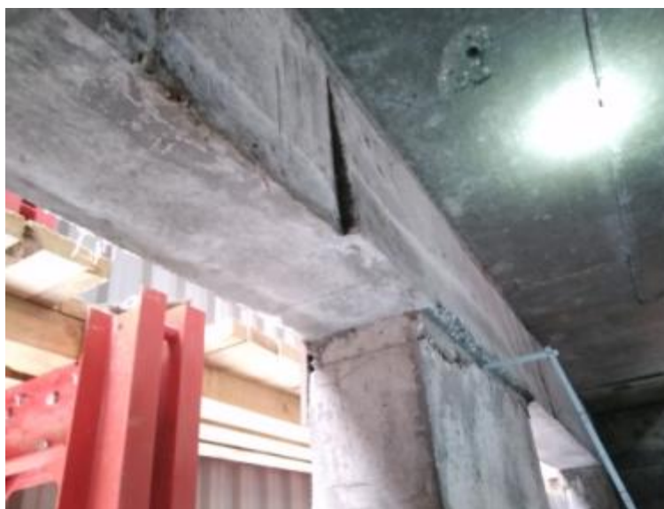
Рис. 6. – Нарушение геометрии монолитной конструкции
