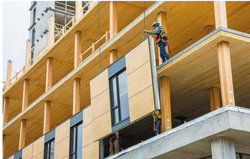
Рис. 13: Монтаж фасадных панелей полной заводской готовности при возведении первого корпуса UBC Brock Commons [12].
